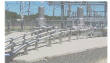
110 kV HTS cable
